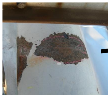
配管バンド部腐食状況
